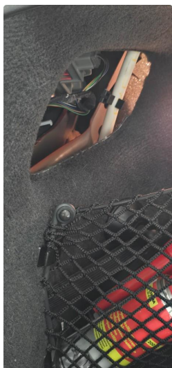
2.1 Innvendig deksel over baklykt, mangler
