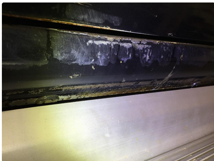
1.8 Begynnende rustutslag oppunder kanaler begge sider
