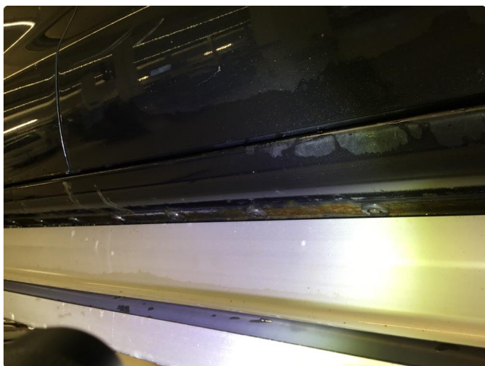
1.8 Begynnende rustutslag oppunder kanaler begge sider
