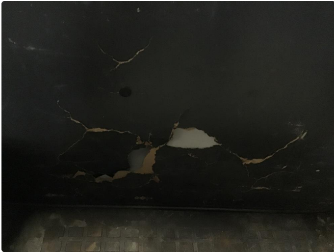
1.1 Skade på deksel i varerom
