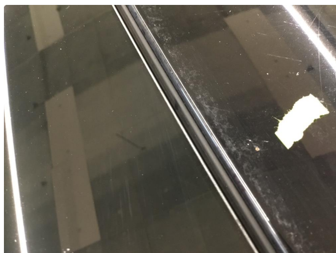
1.3 Noe steinsprut m/rustutslag på taket.
