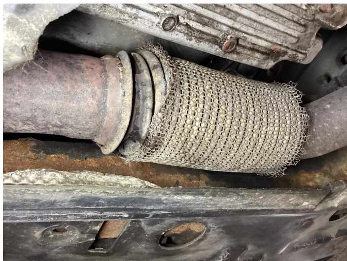
3.2 Skade på flexiør
