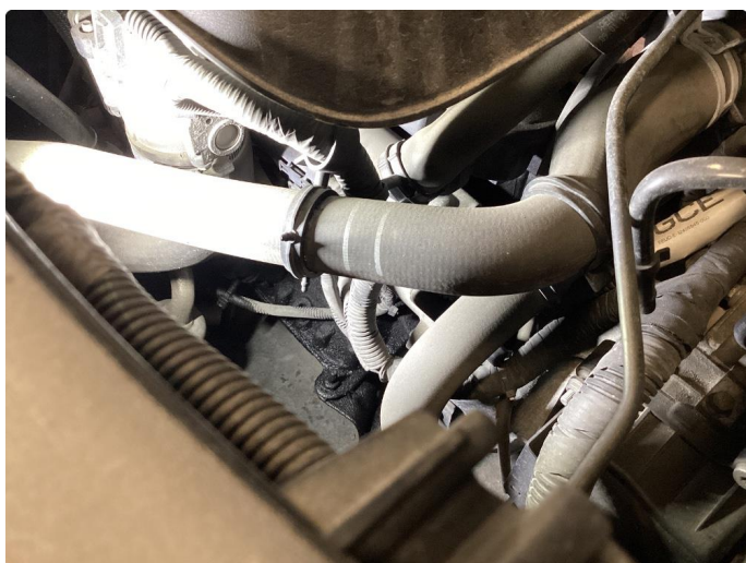
3.4 Oljelekkasje fra motor
