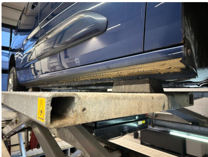
1.6 Matt/slitt lakk underside kanaler begge sider.
