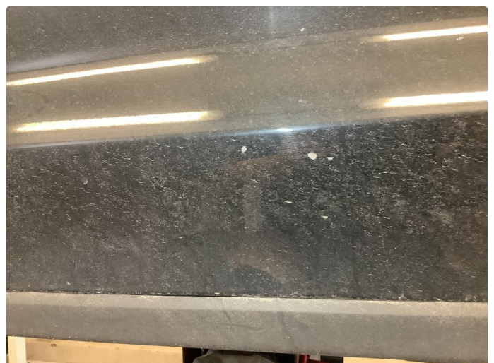
3.1 Generelt mye bruksslitasje
