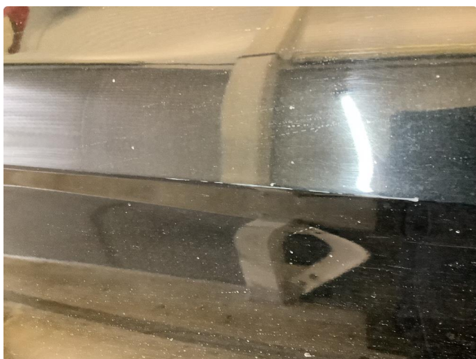
3.1 Generelt mye bruksslitasje
