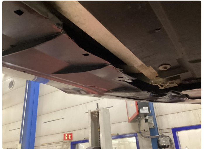
1.3 Beskyttelsesplate under skadet
