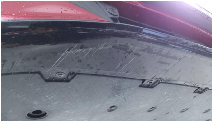
1.1 Riper i plastdel under støtfanger foran
