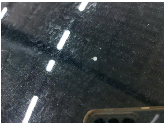
1.2 Steinsprut med rust
