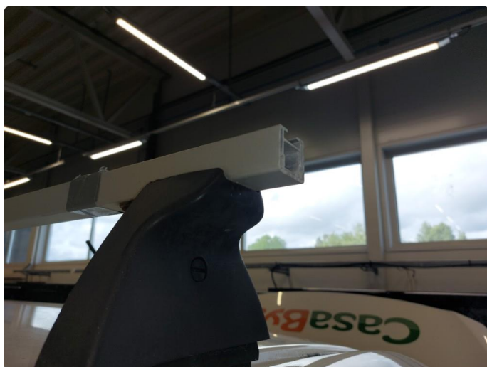
1.2 Deksler på tak/rails mangler
