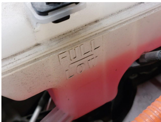
3.1 Kjølevannslekkasje fra vannpumpe
