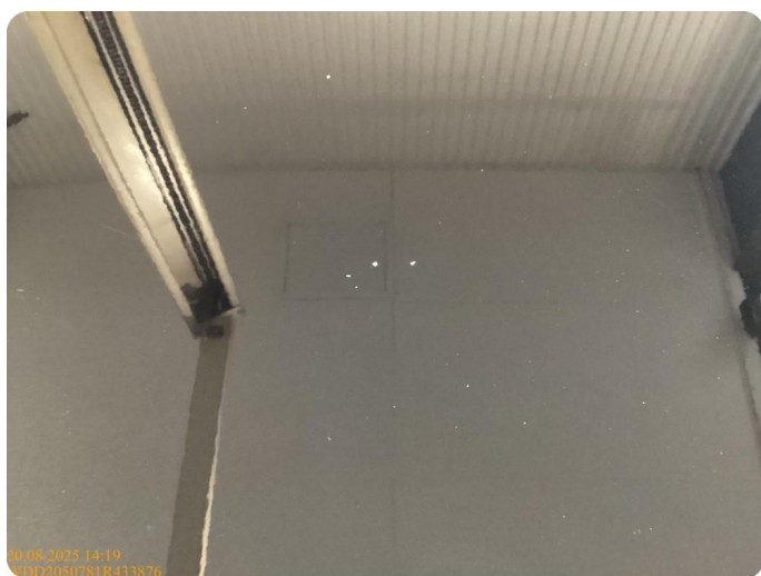
1.3 Steinsprut Noen steinsprut på tak ned til grunning.
