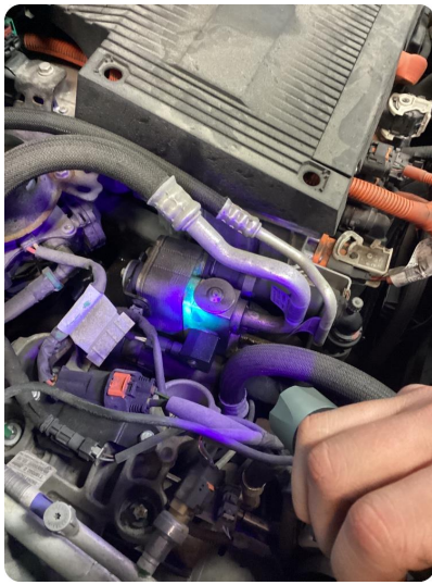
2.1 Lekkasje Stor lekkasje fra epansjonsventil
