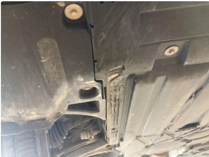
1.1 Liten ubetydelig skade på beskyttelsesplate
