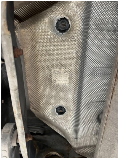
1.2 Stedehvis noe overflaterust under bilen.
