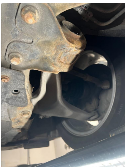
1.2 Stedehvis noe overflaterust under bilen.
