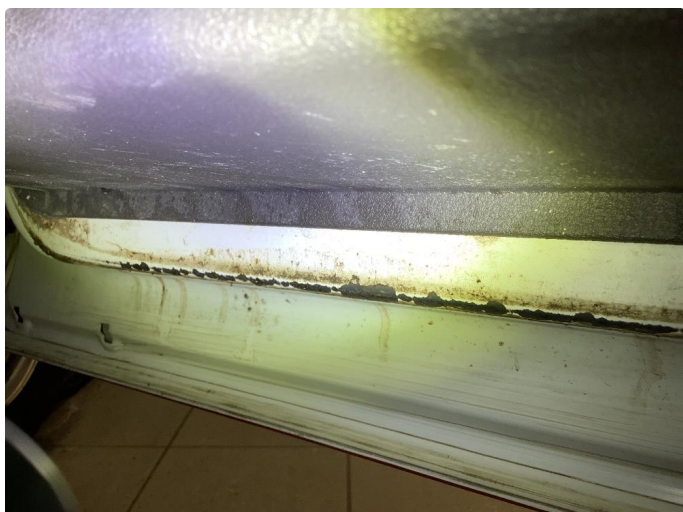
1.1 Lakk slitasje underkant fordører.
