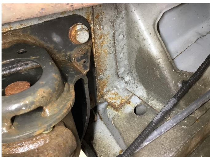
1.1 Noe begynnende korrosjon under bil.
