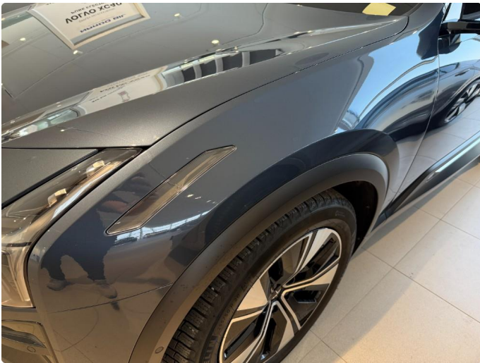
1.3 Steinsprut skjerm venstre foran.
