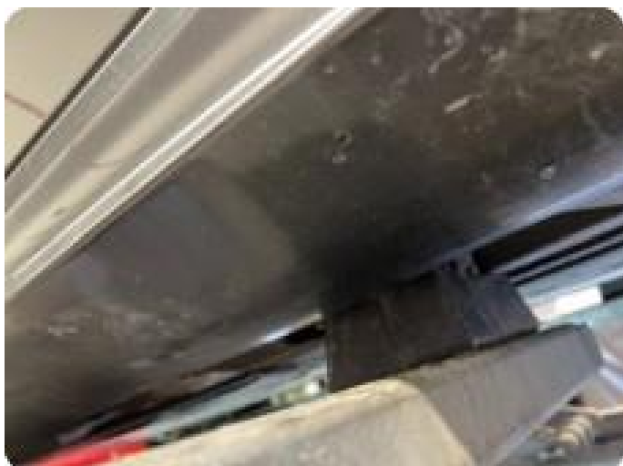
1.1 Merker etter tidligere montert utstyr underside av kanaler og støtfangere.
