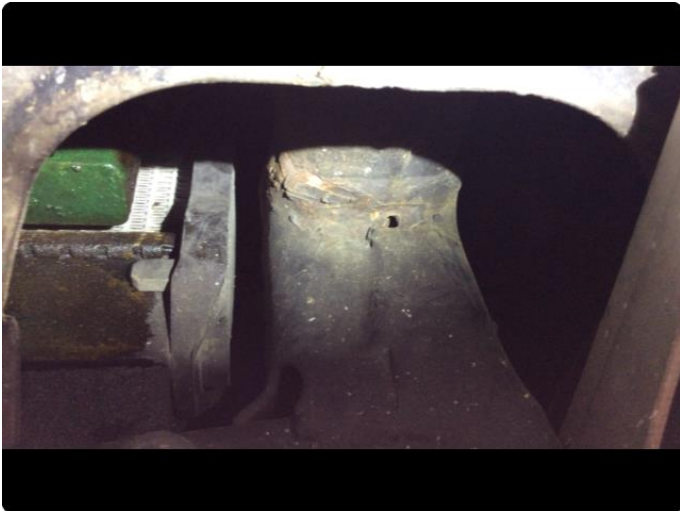
1.1 Lekkasje fra a/c radiator
