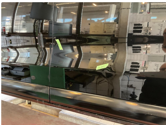
1.2 Bulker i v skyvedør med lakk sår
