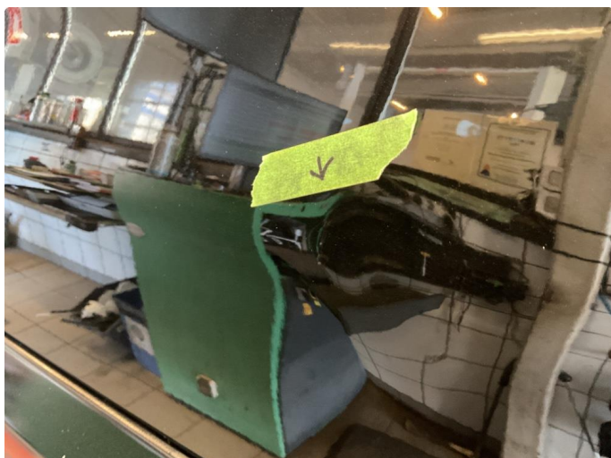
1.2 Bulker i v skyvedør med lakk sår
