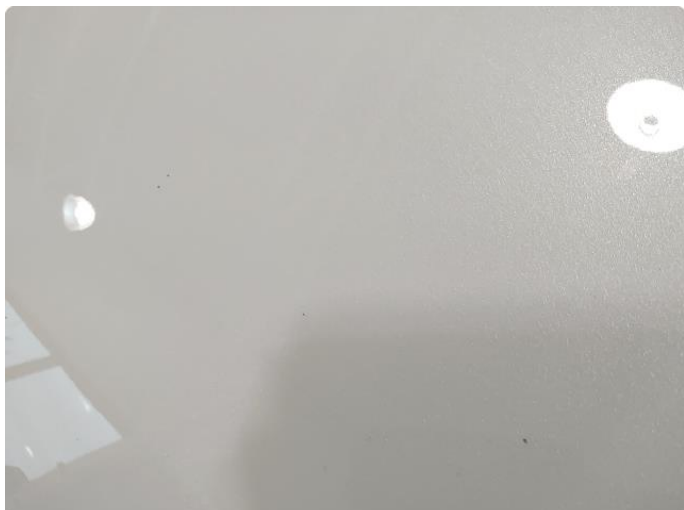
1.1 Smått med steinsprut - normal slittasje
