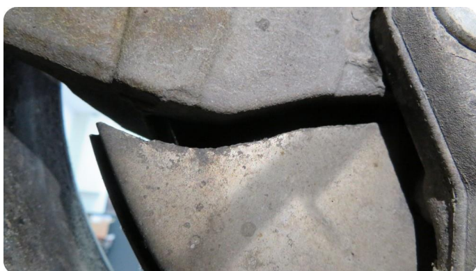
2.1 Rust Påbegynt rust
