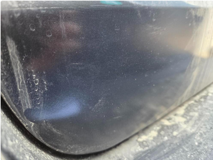
1.1 Ufagmessig utført lakkarbeid - Bakluke
