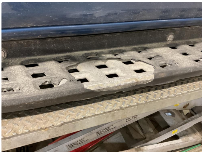
1.1 Lakk på stigtrinn flasser
