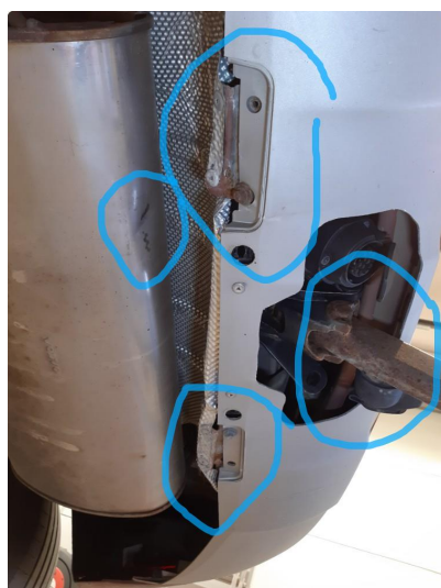
1.1 Generelt mye bruksslitasje
