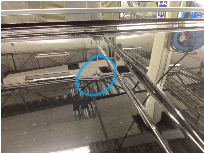
1.2 Liten bulk med lakkskade som er flekket
