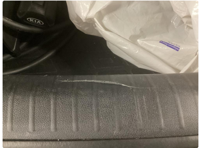
2.1 Ripe/sprekk i deksel innlastingszone
