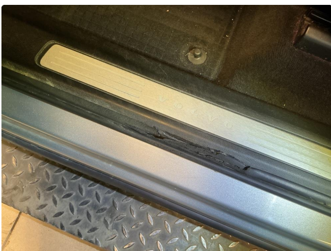
2.1 Skadet pakning dørterskel
