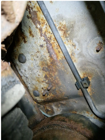
2.1 Rust underside ved bakstilling.
