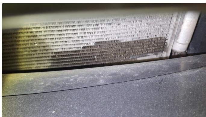
8.1 Lekkasje på ac radiator.
