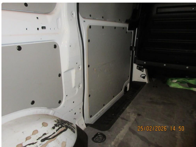
2.1 Diverse riper og slitasje i varerom
