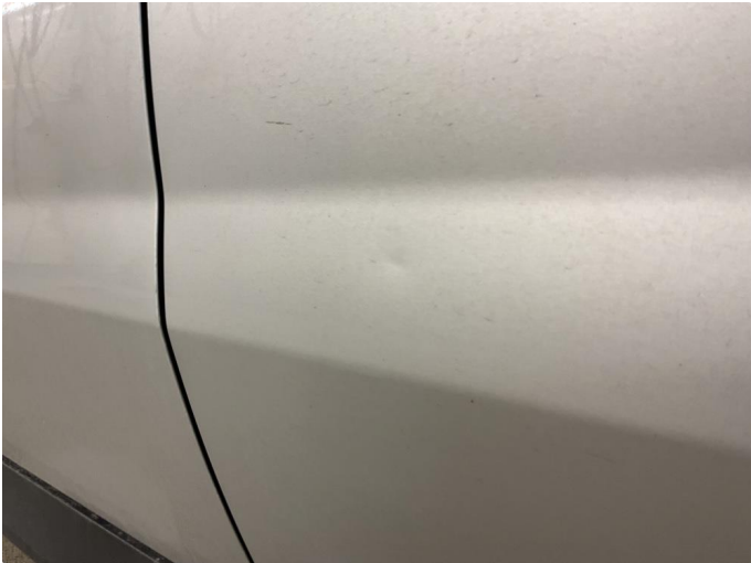
1.1 Noe riper og småbulker
