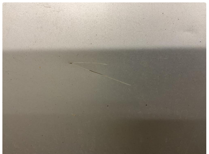
1.1 Noe riper og småbulker
